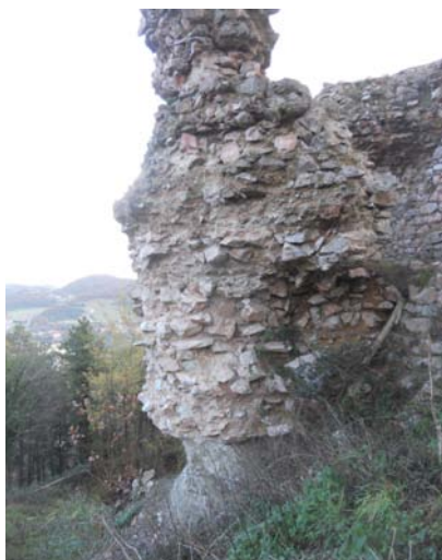
Estado de deterioro de la base del muro de la torre.
