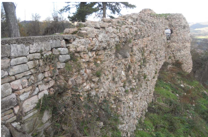
Porción del sistema defensivo superior y su estado de deterioro.
