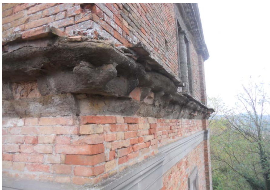
Detalle de las cornisas originales y de sustitución en el frente noroeste (Foto S. Gizzi, 2013).
