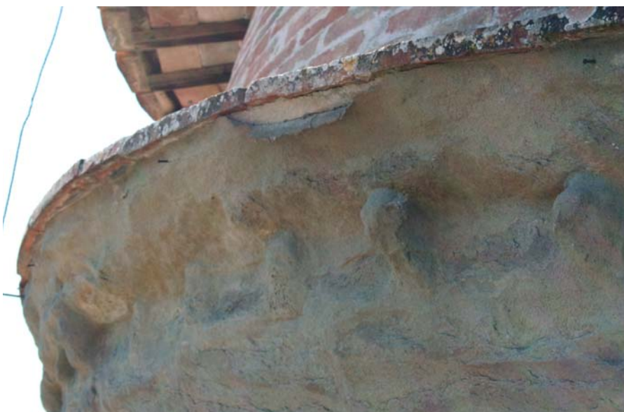
Efectos negativos de la consolidación efectuada con resinas sintéticas en los años Noventa del siglo XX (Foto F. Lanari, 2013).
