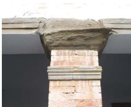
Detalle del deterioro del capitel en piedra arenisca en el claustro (Foto S. Gizzi, 2013).
