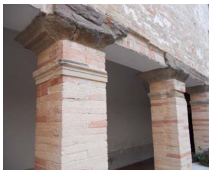
Tipos de ladrillo y deterioro de los capiteles en el claustro del Convento (Foto S. Gizzi, 2013).
