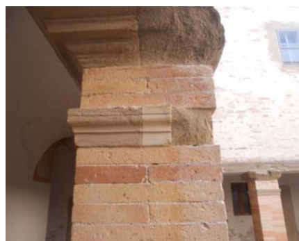
Tipos de los ladrillos y deterioro de los capiteles en el claustro del Convento de San Bernardino (Foto S. Gizzi, 2013).
