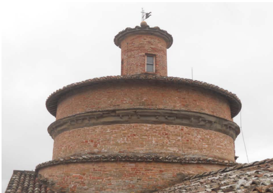
Tambor con evidente deterioro de las cornisas en piedra arenisca.
