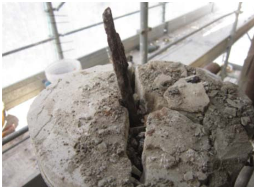
Detalle de la fisura de la columna (Foto Gamma s.r.l. Fano, 2015).
