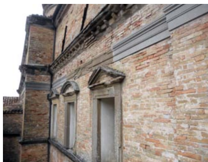
Deterioro de las cornisas del frente noroeste (Foto S. Gizzi, 2015).
