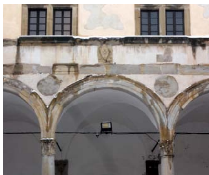
Deterioro de la piedra arenisca en el Palacio Papal de Camerino (Foto S. Gizzi, 2012).
