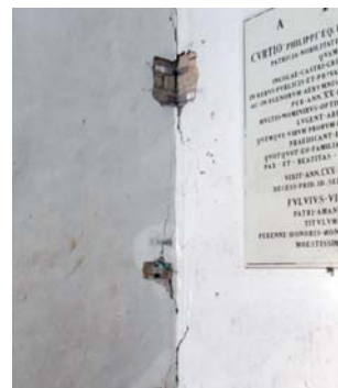
Espías para monitorear las fisuras en el interior de la iglesia (Foto Gamma s.r.l. Fano, 2015).
