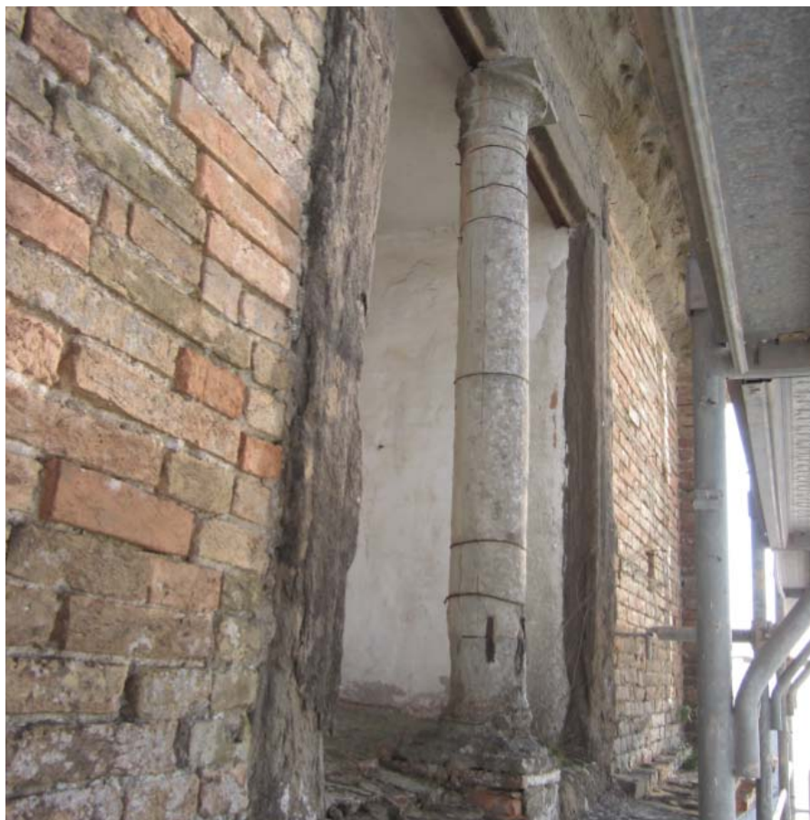
Estado de deterioro de la columnilla de la ventana bifora del frente principal antes de la intervención (Foto S. Gizzi, 2014).
