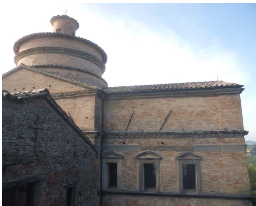
Deterioro de las cornisas del frente noroeste. Nótese las partes reintegradas con piedra arenisca (Foto S. Gizzi, 2012).
